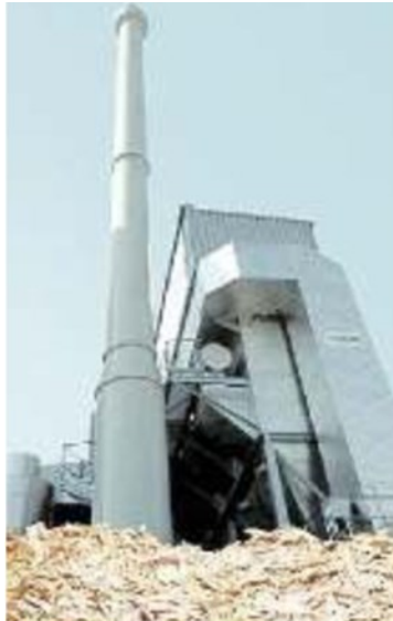
CALDAIA Impianto a biomasse
