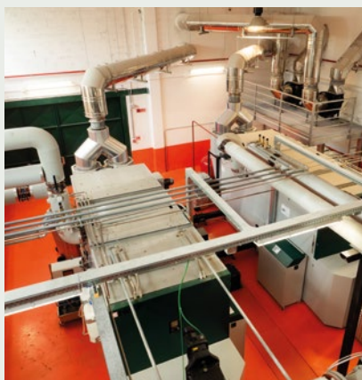
Caldaia a griglia mobile
