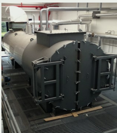
Caldaia a griglia mobile
