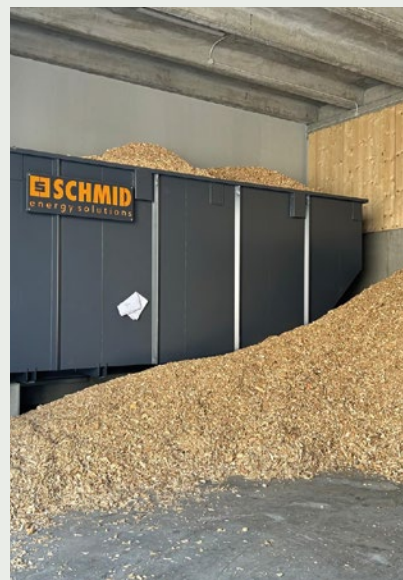
Deposito del cippato
