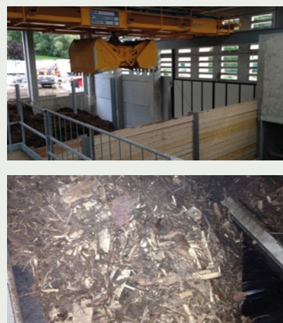
Deposito del cippato
