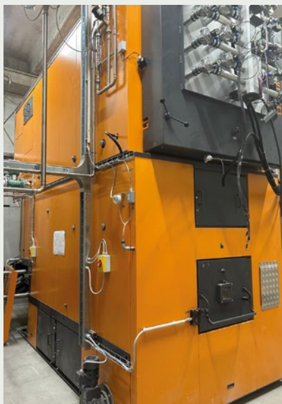
Caldaia a griglia mobile
