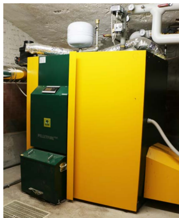
Una delle due caldaie Carbotermo
