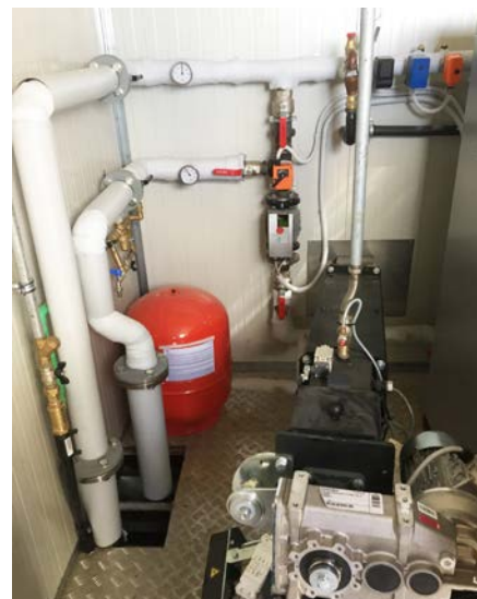
Partenza rete teleriscaldamento da container
