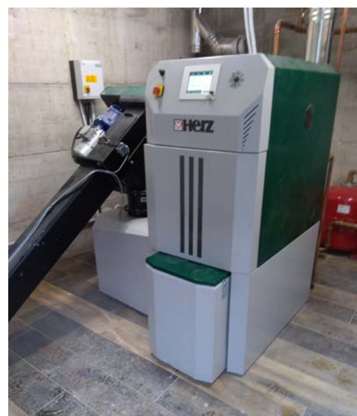
La caldaia Herz Firematic 35, installata presso l'abitazione di uno dei soci della cooperativa Ecosistema, ha sostituito una vecchia caldaia a gasolio
