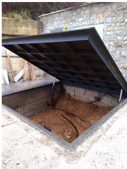
Il vano cippato con rotore a balestre
