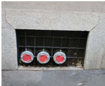
I bocchettoni Storz del sistema di scarico pneumatico del pellet
