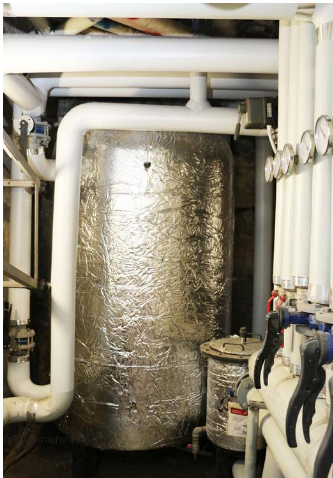
Uno dei serbatoi inerziali
