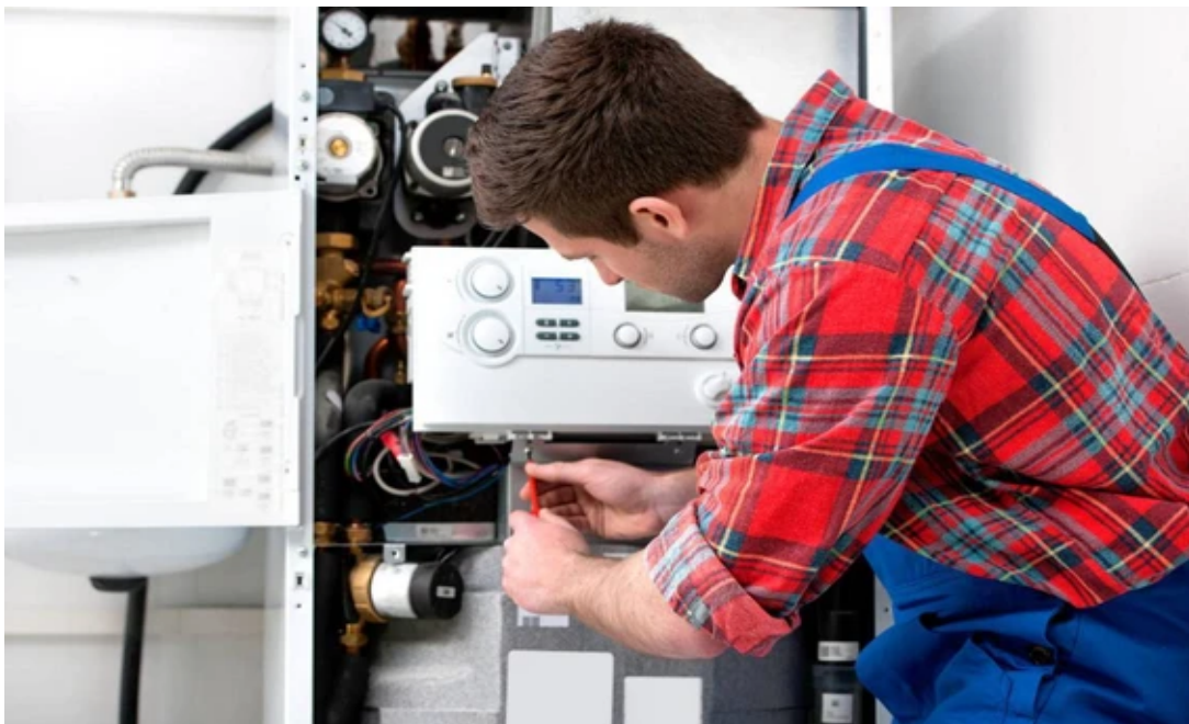
Un tecnico mentre controlla una caldaia (foto di archivio)
