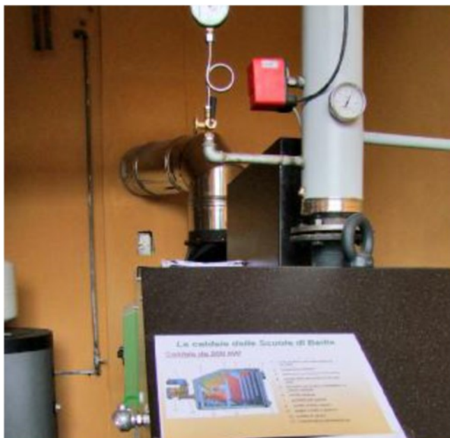
Una caldaia alimentata da biomasse
