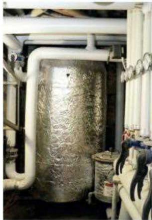
Uno dei serbatoi inerziali
